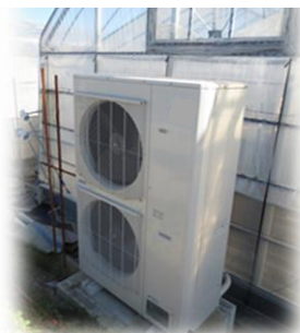
北風など恒常風の影響を受けない場所に室外機を設置
