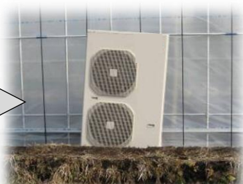
室外機が傾斜、転倒
