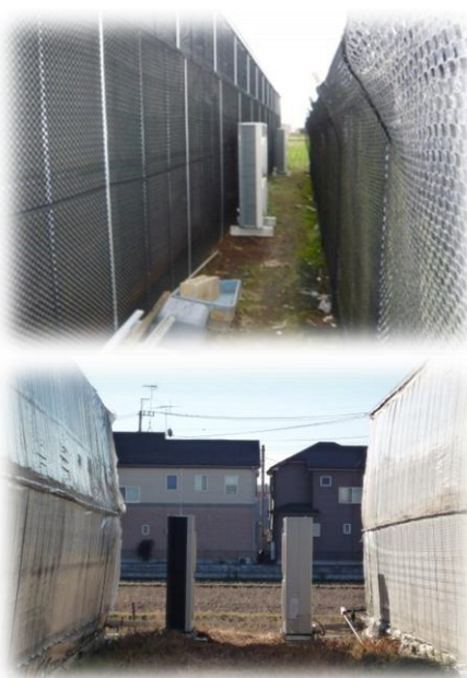
室外機の不適切な設置例 （ショートサーキットが発生しやすい）
