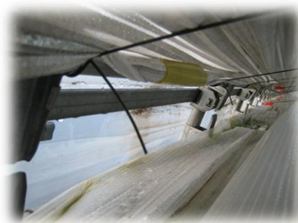
多層カーテン肩部の隙間
