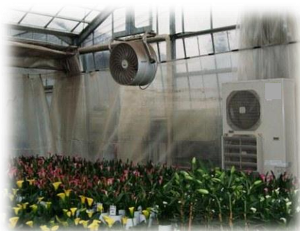
ヒートポンプと循環扇の連動運転
