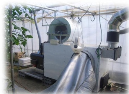
送風ダクトの有効活用
