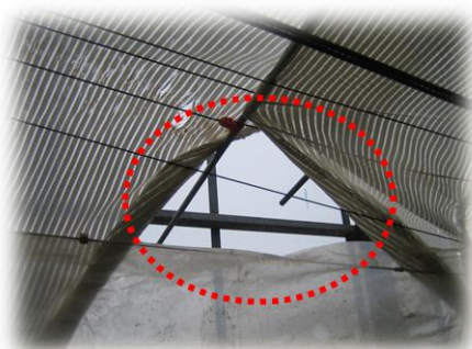
天井カーテンの隙間（妻面）
