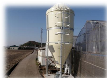
6.4m 3 の貯蔵タンク（高さ5m）
