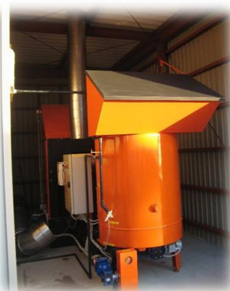
木質チップボイラー
