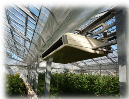
天吊タイプのヒートポンプ
