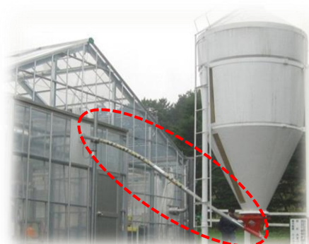
木質ペレット搬送部
