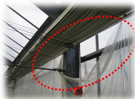
肩部の垂れ下がりによる隙間
