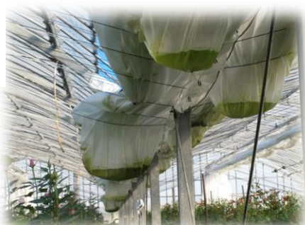
金魚鉢状に膨らんだ内張カーテン
