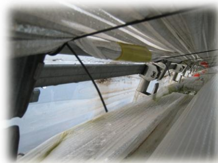
多層カーテン肩部の隙間
