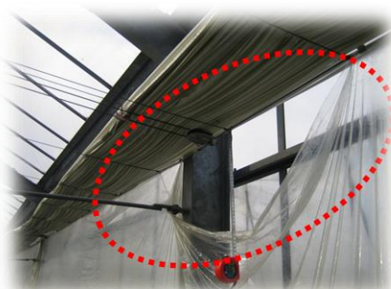
肩部の垂れ下がりによる隙間
