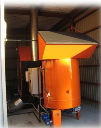
木質チップボイラー
