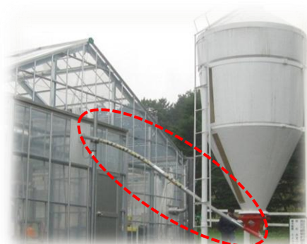
木質ペレット搬送部
