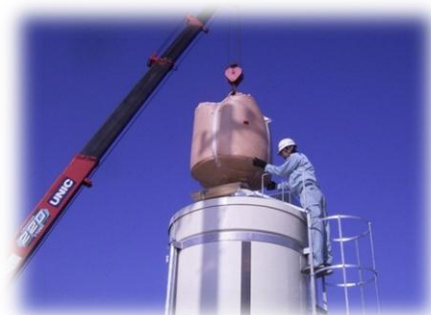
木質ペレット投入状況
