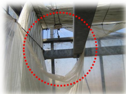
温室のコーナー部の隙間
