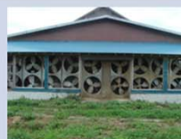
畜舎壁面の換気扇
