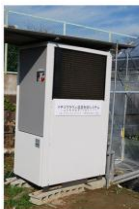
冷水製造装置
