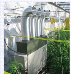
施設内のヒートポンプ
