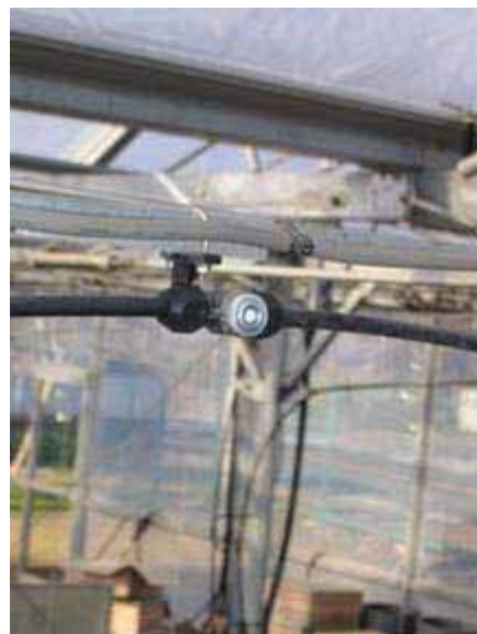
(写真6:細霧冷房) 5～30ミクロンの細霧の蒸発潜熱によって、施設内の気温を下げるもの。十分な換気が行われないと、その効果は発揮できない。
