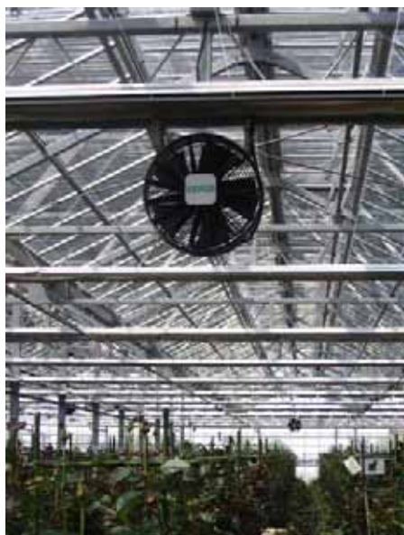
(写真5:循環扇) 施設内の空気を攪拌することにより、温度ムラをなくす装置。
