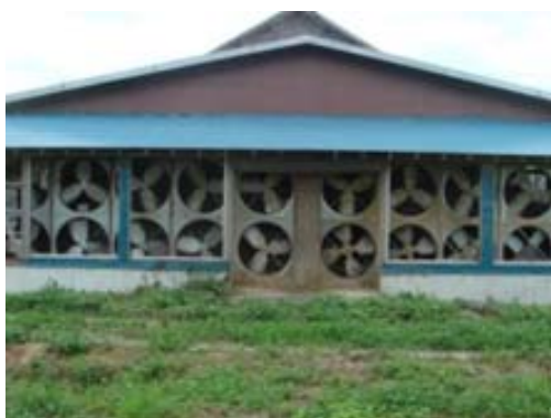
畜舎壁面の換気扇
