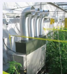
施設内のヒートポンプ
