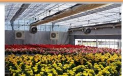
夜間冷房にも利用されるヒートポンプ
