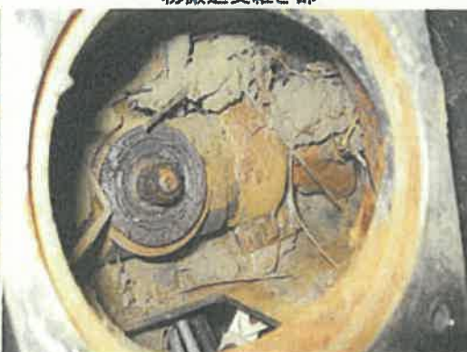
糞搬送受継ぎ部
