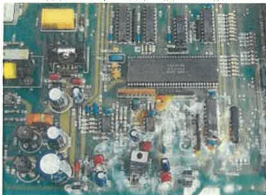
操作盤(基板が塩水に浸かった跡)
