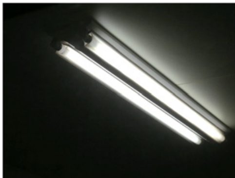
図3 蛍光灯カバーによる飛散防止
