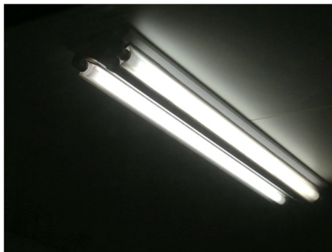
図3 蛍光灯カバーによる飛散防止
