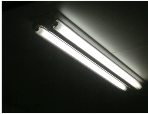
図3 蛍光灯カバーによる飛散防止
