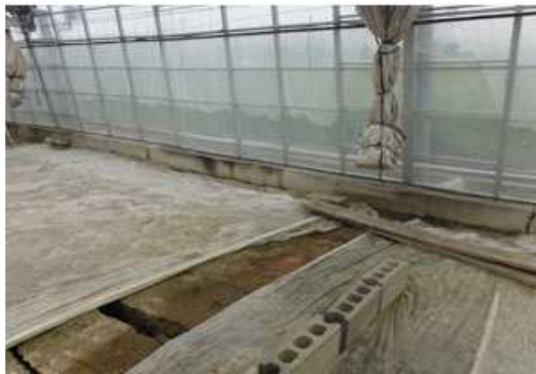
育苗ハウスの地割れ
