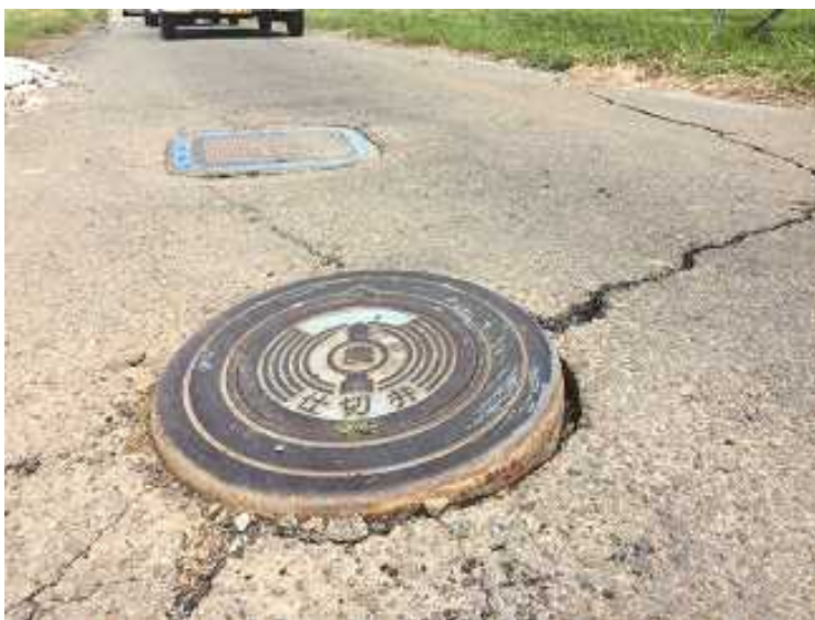
道路の亀裂により 道路下の水路の損壊のおそれ
