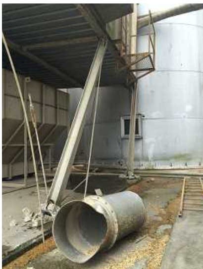
支柱基部の損壊、配管の落下
