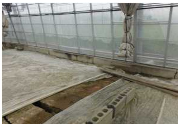
育苗ハウスの地割れ
