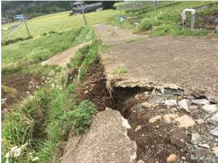
農道が大きく地割れ
