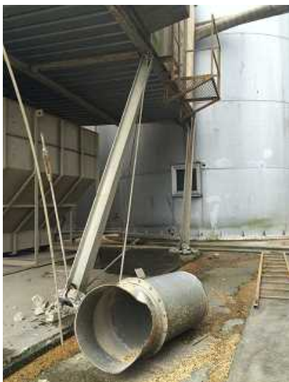
支柱基部の損壊、配管の落下
