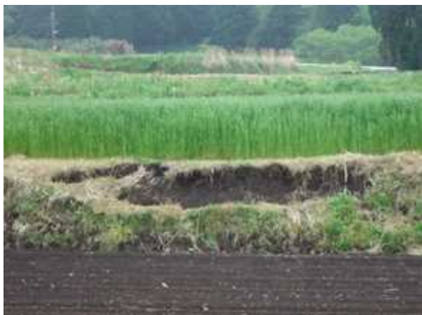
二条大麦ほ場の法面の損壊（大津町）
