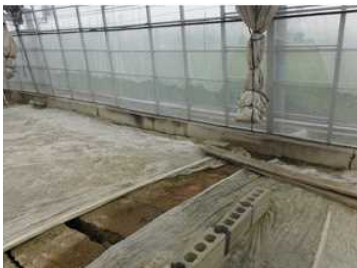
育苗ハウスの地割れ
