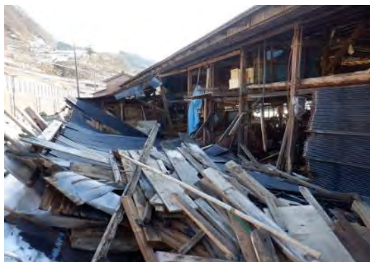
屋根や柱が倒壊した船小屋
