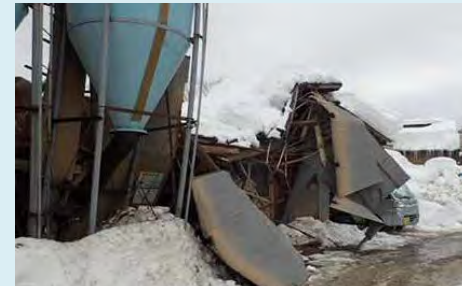
・積雪による牛舎の倒壊
