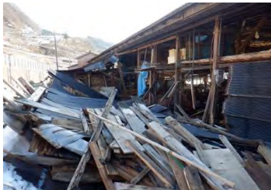
屋根や柱が倒壊した船小屋
