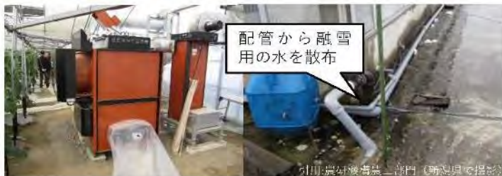
融雪装置 (加温機等) の設置
