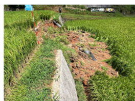
農地の法面崩壊
