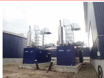
令和6年11月に設置された発電機
