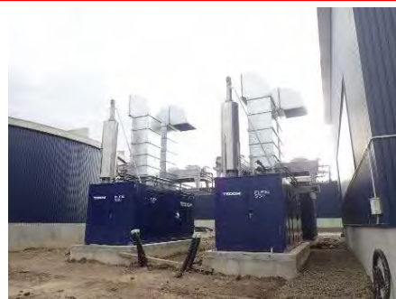
令和6年11月に設置された発電機
