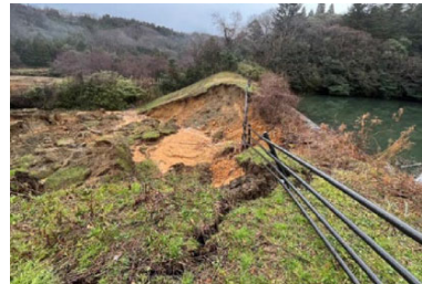
ため池の被害
