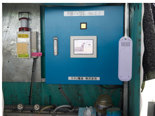
肥料濃度を管理するシステム。
