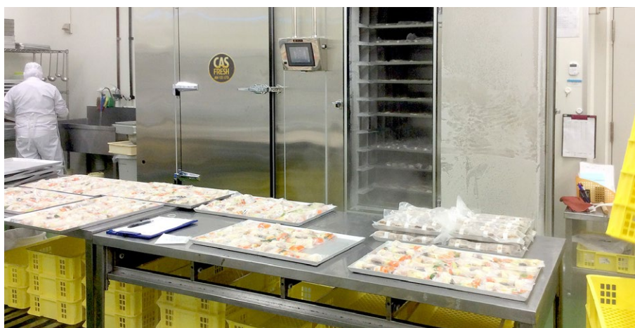
食品工場内に使用されているCAS付凍結機。
