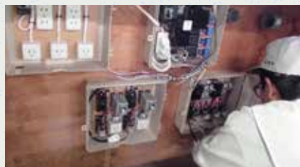
ハウス制御装置の設置。
