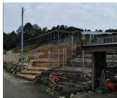
【ソーラーパネルを設置】
