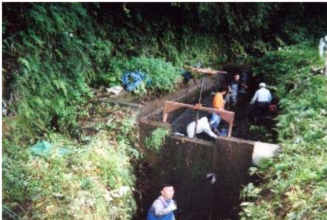
集落による水路の維持管理 徹底したゴミ等の除去を実施した。
