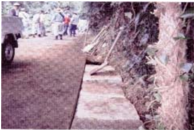
着手前（水路が土砂で埋まっている）
