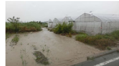
【湛水被害の状況】
