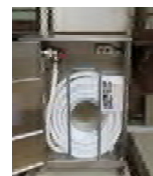
(易操作性1号消火栓)
