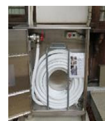
(易操作性1号消火栓)
