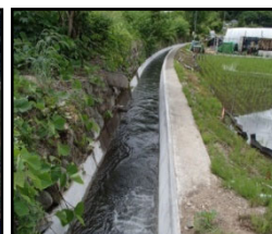
老朽化した用水路の整備・更新
