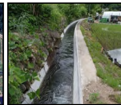
老朽化した用水路の整備・更新
