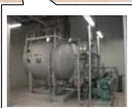
加須市大越地区の真空管路施設
