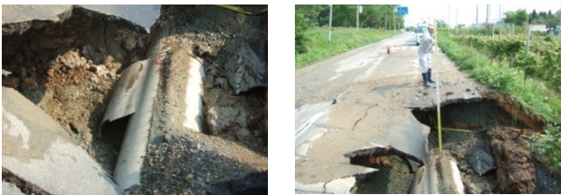
突発事故事例（パイプラインの破裂）
