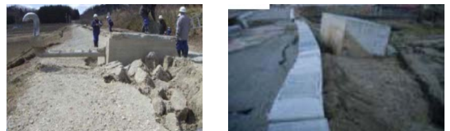
東日本大震災における損傷事例（パイプライン附帯施設）
