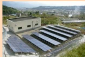
農業水利施設を活用した太陽光発電
