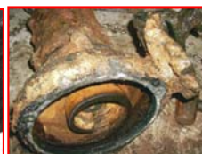
ポンプ腐食状況
