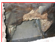
コンクリート腐食状況
