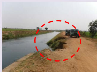
土水路側面の崩壊
