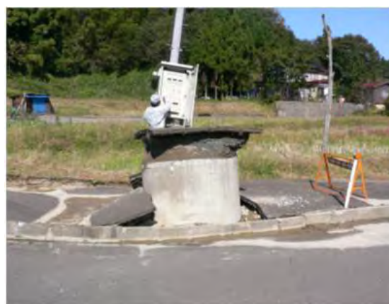
写真-3-2 中継ポンプの緊急点検・調査状況 (中継ポンプの被災状況の調査)
