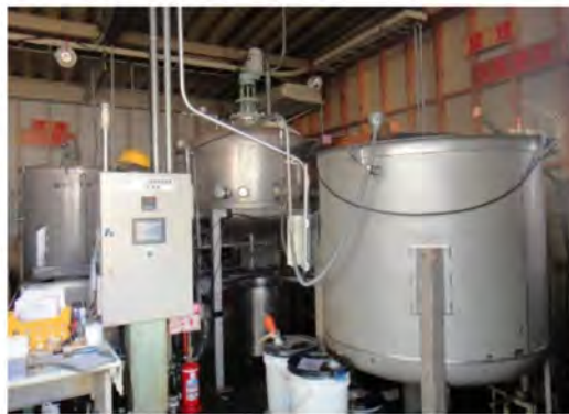
バイオ燃料生成プラント
