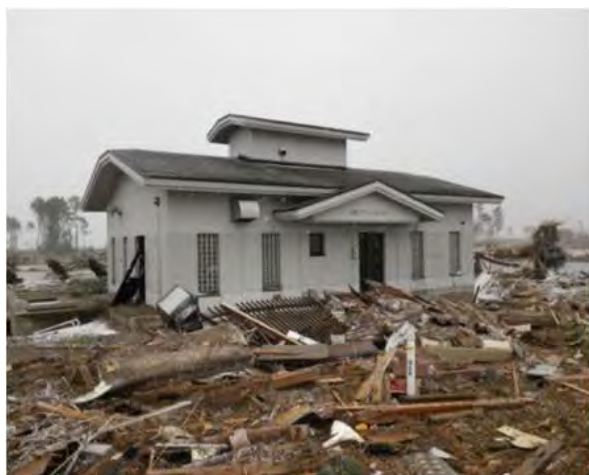
写真-3-7 津波により瓦礫に埋まった 汚水処理施設
