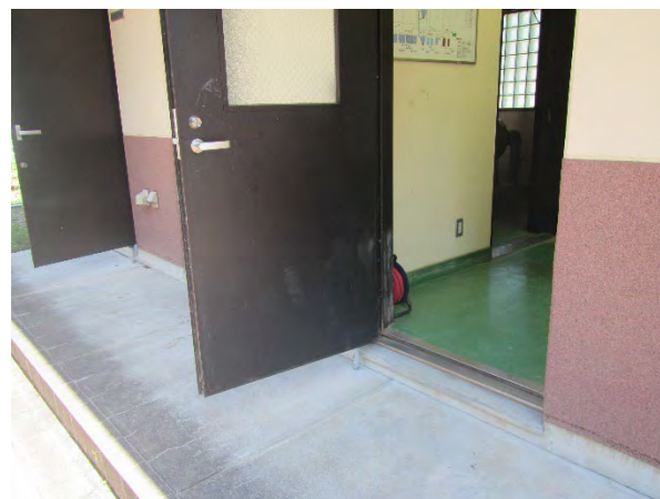
写真－６－８ 汚水処理施設建屋 ドアガラリなしの扉
