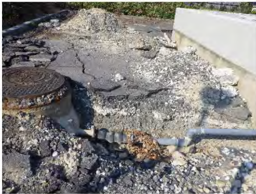
外構の被災状況
