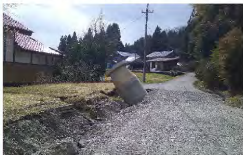
浮上したマンホール
