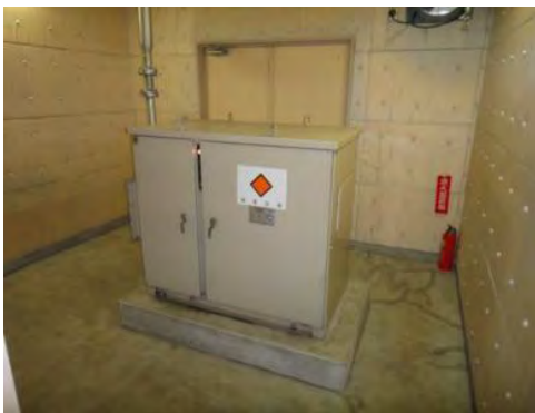
写真－６－１２ 非常用発電設備
