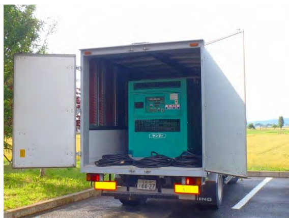
写真-4-4 発電機搭載車
