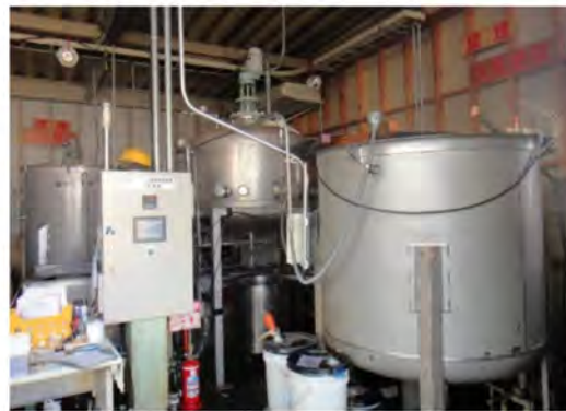
バイオ燃料生成プラント
