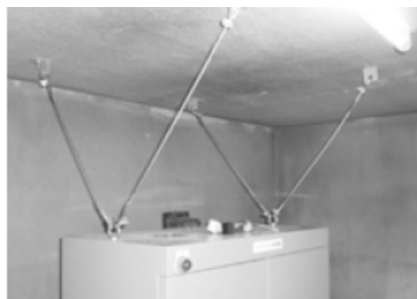
写真-6-11 制御盤の転倒防止 (出典：株式会社コムテック HPより)
