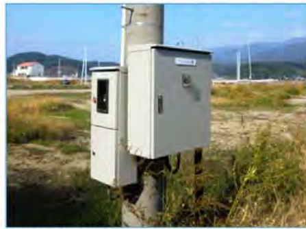
いち早く復旧した電柱に仮設の受電盤、制御盤を架設
