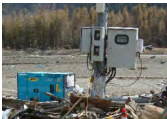
写真-4-5 中継ポンプ制御盤と可搬式発電機
