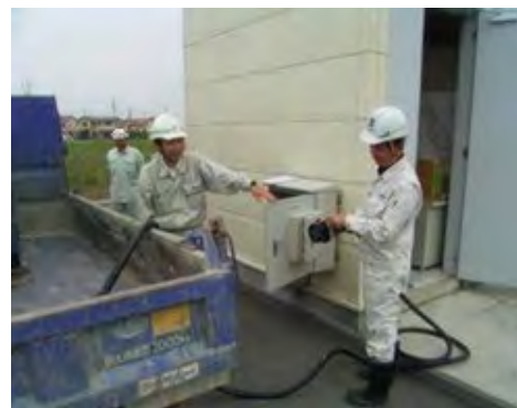
写真－６－１３ 外部電源用の非常用電源受電盤
