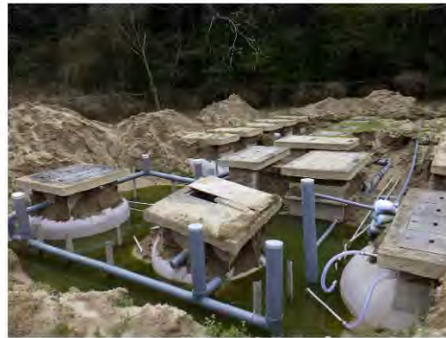
盛土崩壊の状況
