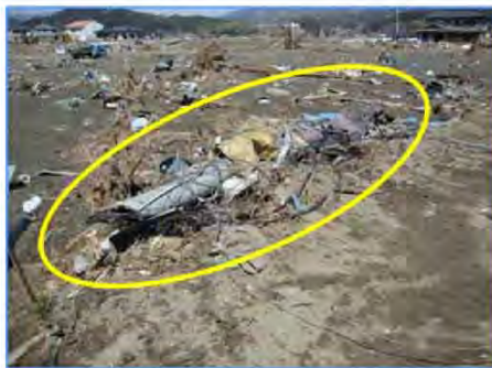
被災した中継ポンプの受電盤、計装盤
