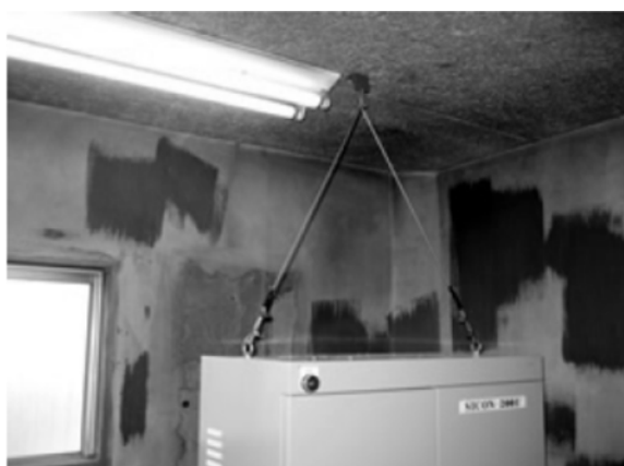
写真-6-10 制御盤の転倒防止 (出典：セイワエレベーター株式会社 HPより)
