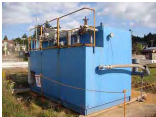
写真-4-7 ユニット型仮設污水处理施設
