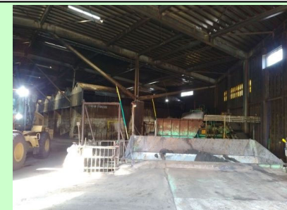
肥料化施設内の発酵設備
