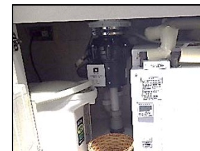
▼設置状況（黒部市役所）
