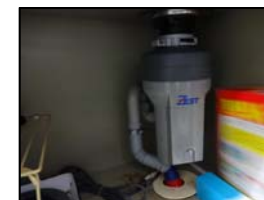
▼ 宅内設置状況(現在)
