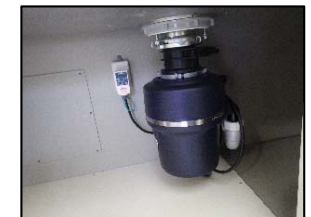
▼設置状況（黒部市浄化センター）
