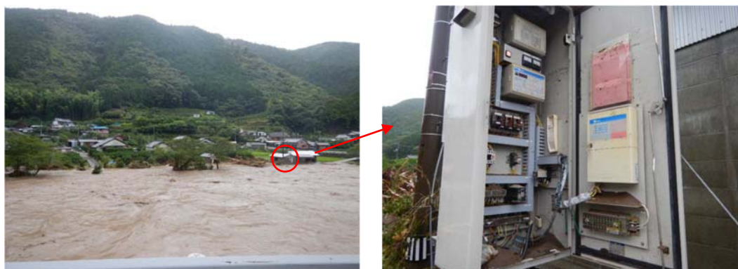
写真－６－２ 中継ポンプ制御盤の冠水
