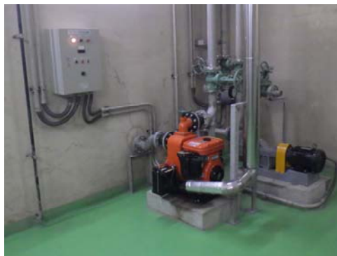
写真－６－１２ 非常用エンジンポンプ
