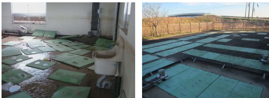
写真－６－７ 左：浸水により浮遊した処理施設の蓋 右：適切に固定された処理施設の蓋
