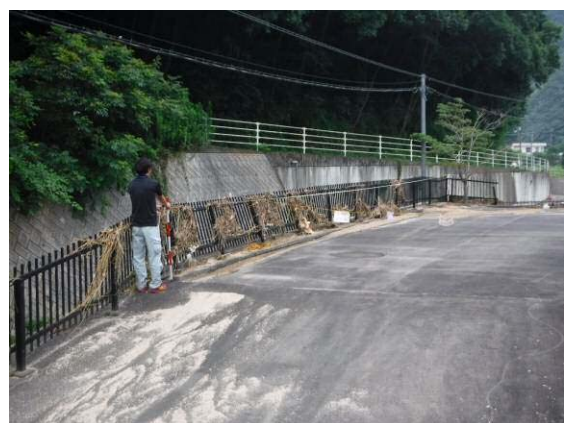
フェンスの破損
