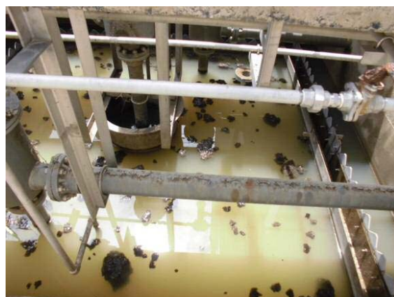
沈殿槽 土砂流入
