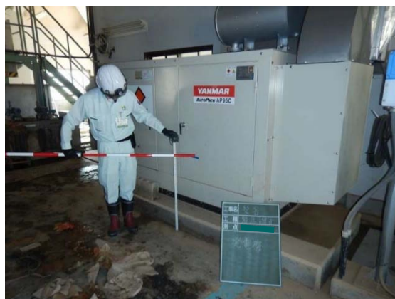
浸水による自家発電機の故障
