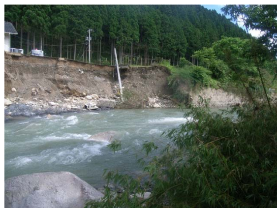
河川護岸洗掘による場内舗装の破損と引込柱の倒壊
