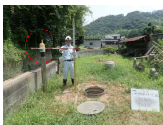
浸水による真空弁通報装置の故障
