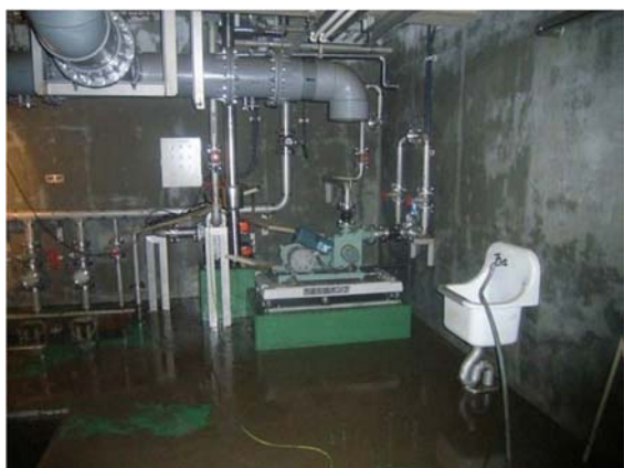
停電に伴い管路からの汚水流入により地下前処理室（非常用エンジンポンプは燃料切れ）の非常用エンジンポンプ、汚泥引抜ポンプが故障・要交換
