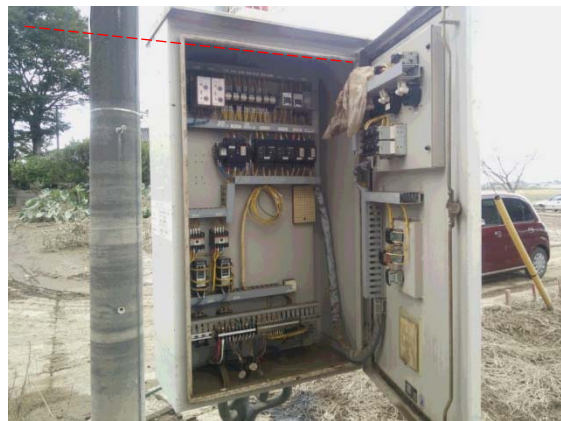
中継ポンプ制御盤の浸水（同左）
