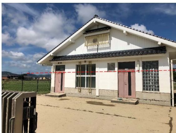
污水处理施設の浸水
