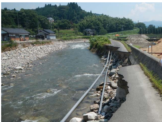
河川護岸洗堀による管路破損
