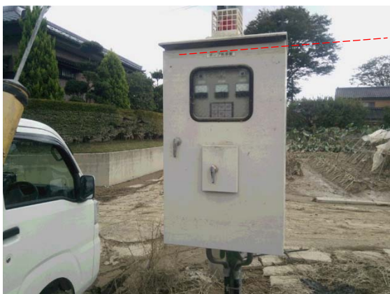
中継ポンプ制御盤の浸水
