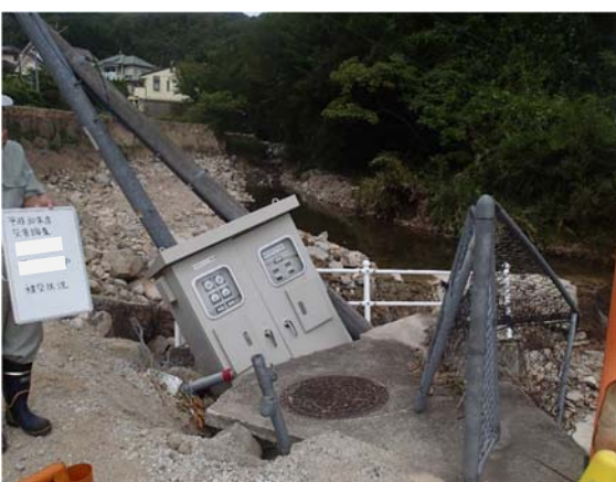
河川護岸崩壊による中継ポンプ、盤類、引込柱等の倒壊
