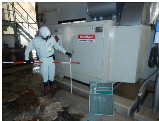
浸水による自家発電機の故障
