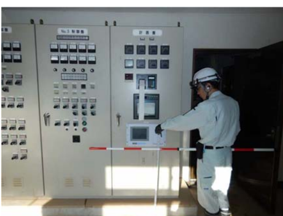
浸水による計装盤の故障 (浸水ラインより上でも水面揺動の影響を受ける)
