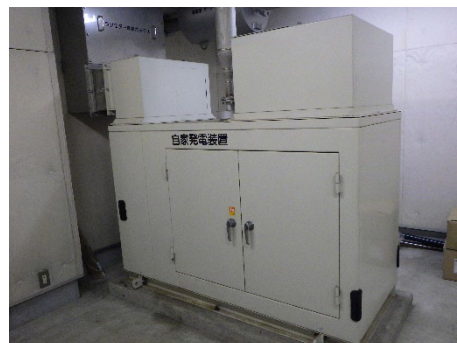
写真4-4-3. 停電対策 (非常用発電設備)
