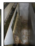
汚水計量槽 の四角堰
