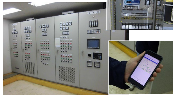
写真 1－6．遠方監視システムの導入
