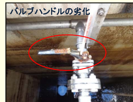
S-4: 変状兆候(軽微な変状)
