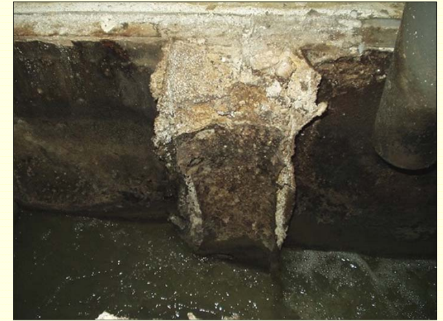
S-2: 顕著な変状あり(粗骨材の剥落)
