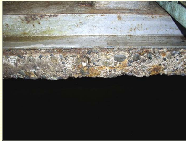
S-3: 変状あり(粗骨材の露出)
