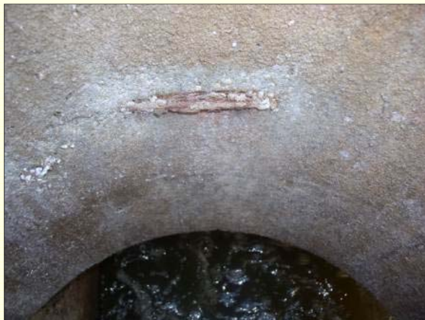
S-3: 変状兆候(部分的な鉄筋露出)
