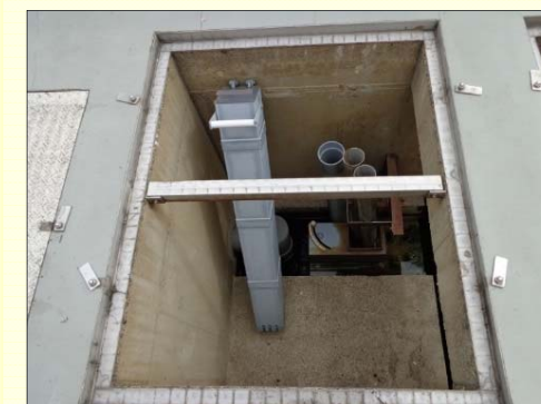
S-4: 変状兆候(軽微な変状)
