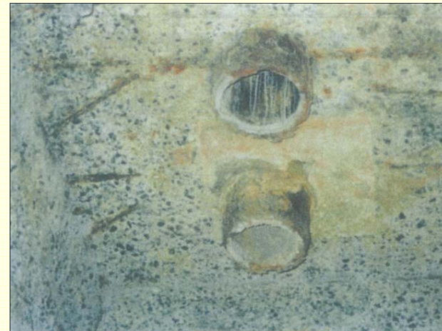
S-2: 顕著な変状あり(全体的な鉄筋露出)
