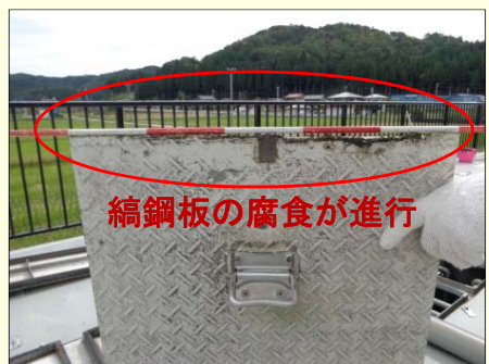
S-4: 変状兆候 (軽微な変状)
