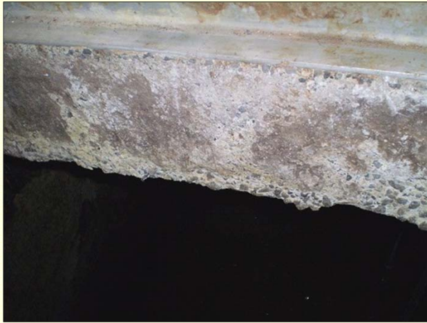
S-4: 変状兆候(細骨材の露出)
